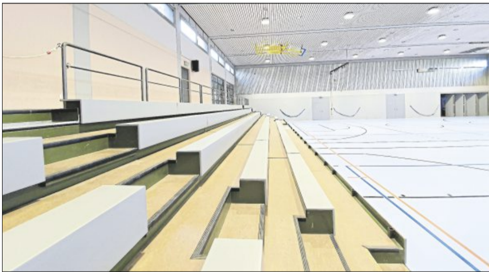
Die Treppenaufgänge und das Geländer müssen noch erneuert werden.
